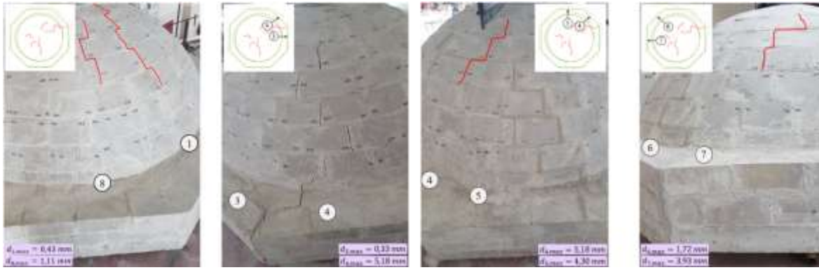
Şekil 4. EM numunesi üzerinde oluşan çatlaklar.
