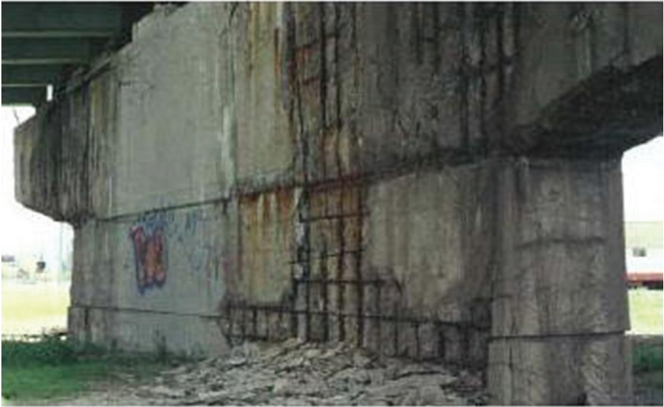
Şekil 17. Paslanan Donatı Betonu Çatlatır
